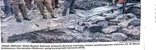
TIDAK SESUAI. Wakil Bupati Sidoarjo Subandi (barni) meninjau lokasi pembangunan saluran air di Desa Entekowon, Kecamatan Badaran, yang kurang baik rencana.
