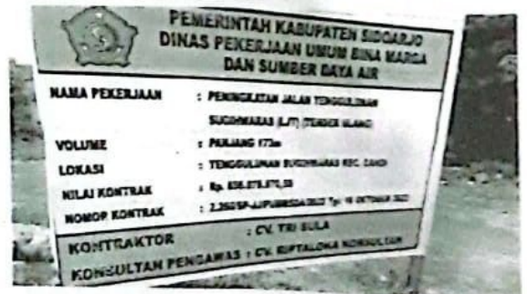
Proyek peningkatan jalan betonisasi ruas jalan Tenggulunan Sugiwaras yang diduga acak acakan pemasangan betonisasi dan box culvert
