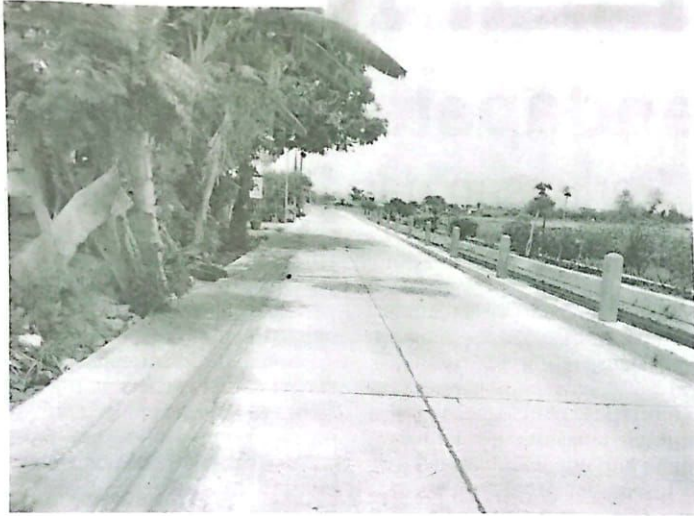
BETON - Proyek betonisasi ruas jalan Desa Banjarsari - Damarsih, Kecamatan Buduran, Sidoarjo saat ini pengerjaannya mencapai 95 persen dan tinggal finishing pekerjaan jalan sepanjang 1.838 meter dan lebar 5 meter itu, Rabu (22/11/2023).
