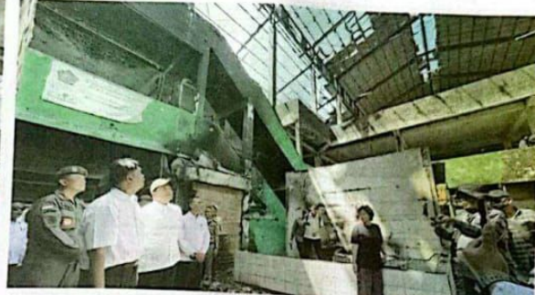
PERIKSA: Plt Bupati Sidoarjo Subandi meninjau kondisi Pasar Krian sehari pasca terbakar kemarin (21/8).
