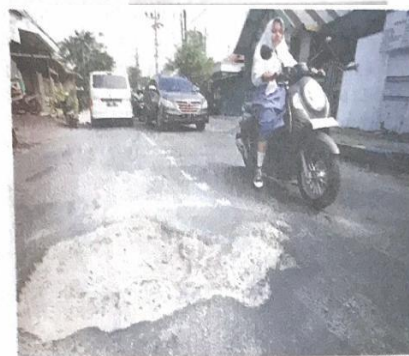
RAWAN: Pengendara melambatkan kendaraannya saat melewati jalan berlubang di Jalan Samanhudi kemarin.
