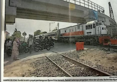
HAMBUR SELASA: Kondisi terakhir proyek pembangunan flyover Krian kemarin. Setelah beberapa pengerjaan minor dan uji coba, flyover bisa digunakan.
