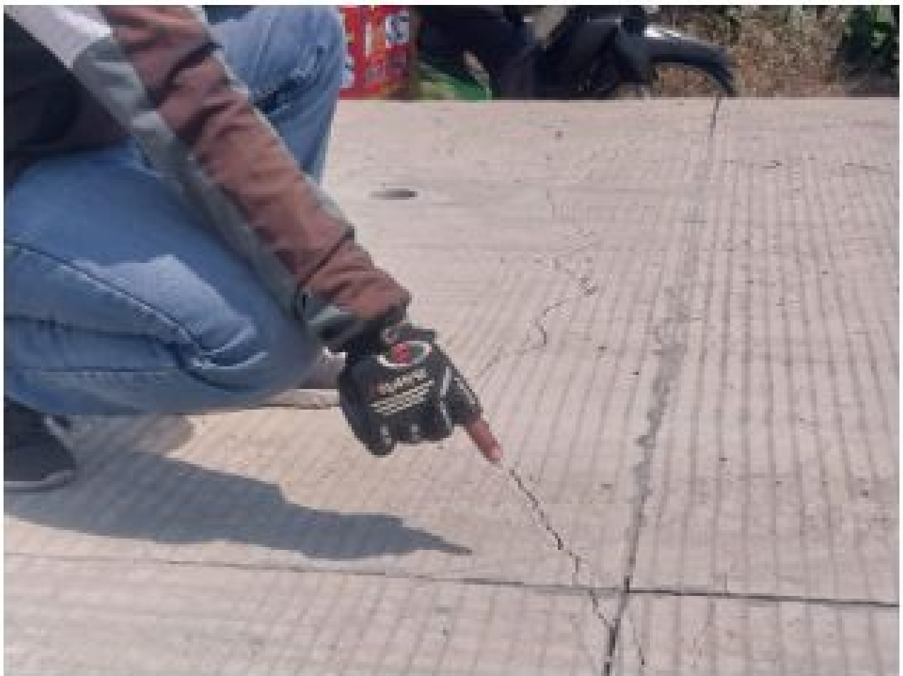
Warga saat menunjuk hamparan beton rusak jalan Krembung-Mojoruntut mengalami retakan. Foto: (cong RyaFi)
