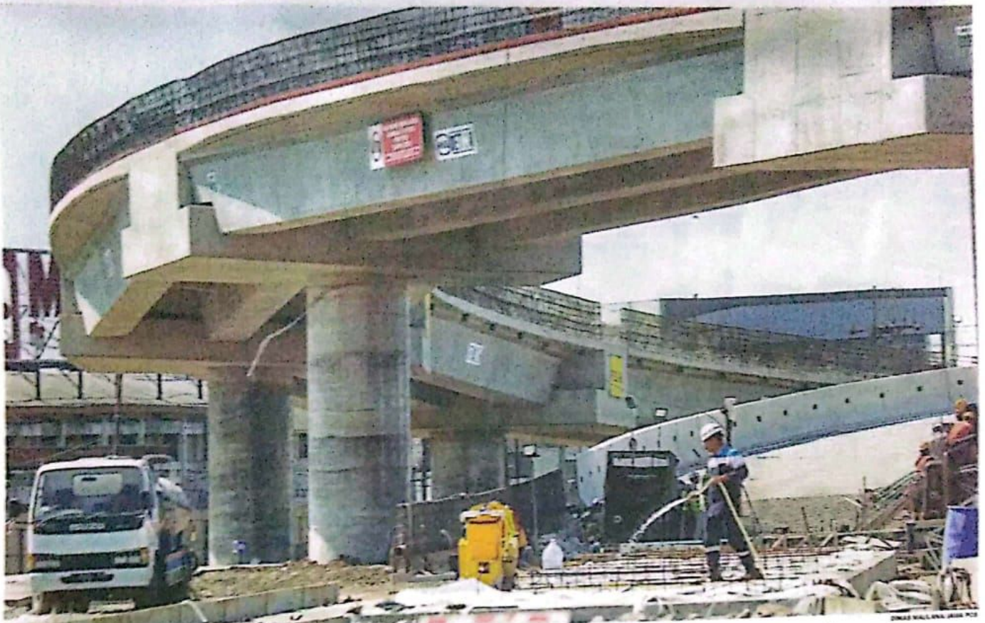
DIGARAP MALAM HARI: Pekerja menyelesaikan pembangunan flyover Djuanda kemarin. Girder flyover Djuanda sisi utara rencananya dipasang malam ini.
