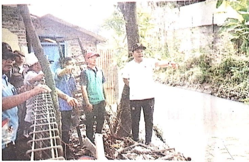
Wabup H Subandi memastikan rumah pompa berfungsi mengantisipasi tingginya curah hujan akhir-akhir ini.
