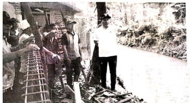
Wabup Sidoarjo Subandi tinjau rumah pompa
