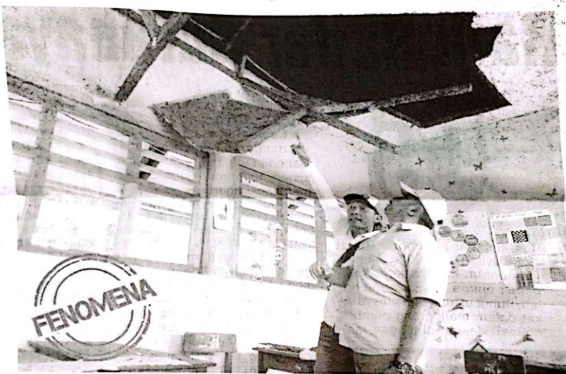
RUSAK: Ketua Komisi D DPRD Sidoarjo Moch Dhamroni Chudlori (kanan) mengecek kondisi ruang kelas SDN Gelang 2 Tulangan yang rusak akibat plafon ambrol, Rabu (5/8).
