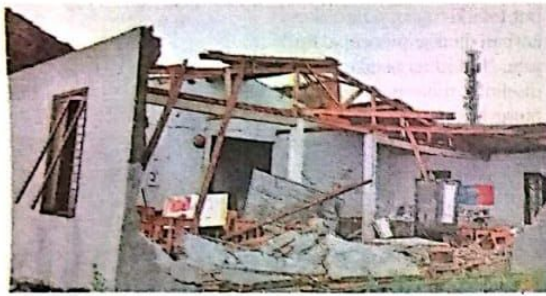
NYARIS AMBRUK: Kondisi ruang kelas MI As Syakira, Keper, Krembung, yang rusak parah setelah diterjang angin kencang dan hujan deras.
