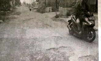
▲ Jalan Desa Simogirang sepanjang 2 Km rusak parah. (par)
