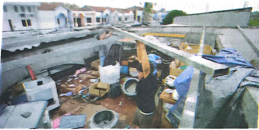
RUSAK PARAH: Ahmad Wildan, pemilik ruko di Perumahan Graha Anggrek Mas, memperbaiki atap bangunan yang jebol usai terdampak angin kencang Minggu (17/5) sore.
