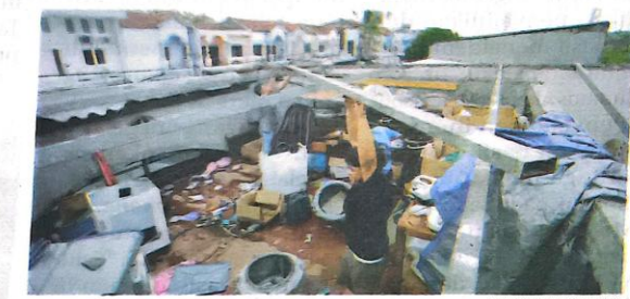
RUSAK PARAH: Ahmad Wildan, pemilik ruko di Perumahan Graha Anggrek Mas, memperbaiki atap bangunan yang jebol usai terdampak angin kencang Minggu (17/5) sore.
