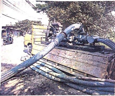
DIBANTU: Pompa mobile dipasang di Kecamatan Jabon untuk membantu irigasi sawah di tiga desa kemarin.
