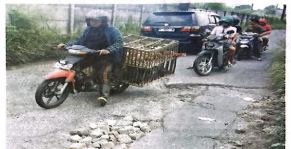
MEMBAHAYAKAN: Para pengendara berhati-hati saat melintasi Jalan Embong Kali, Kemas, Krian yang rusak kemarin (20/4).
