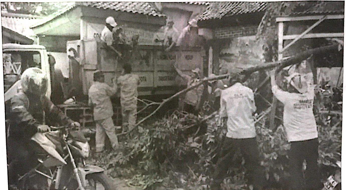
TERDAMPAK ANGIN KENCANG: Warga gotong-royong dengan dibantu BPBD Sidoarjo memperbaiki rumah-rumah yang rusak akibat terdampak angin kencang di Dusun Kempreg Desa Tanjungsari, Kecamatan Taman, Kabupaten Sidoarjo. BM1ST
