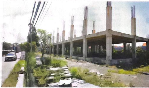
Laksmie berharap, pembangunan RSUD Sedati kali ini bisa berjalan lancar hingga selesai sesuai target.
