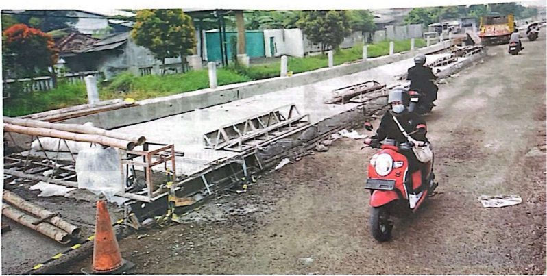
TIDAK DITUTUP TOTAL: Kondisi Jalan Gedangan-Betro bisa dilewati kendaraan namun secara bergantian kemarin (6/7).
