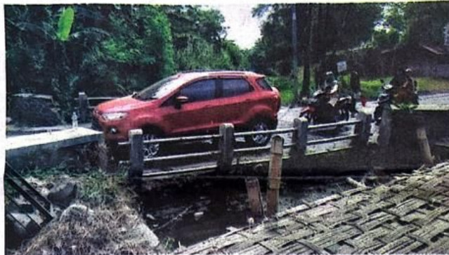
SEGERA DIPERBAIKI: Kondisi jembatan Prasung di Kecamatan Buduran yang akan dibangun kembali.
