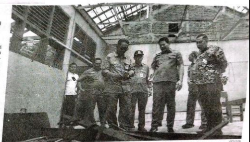
Bupati Sidoarjo Subandi sidak SMPN 1 Gedangan yang ambruk.
