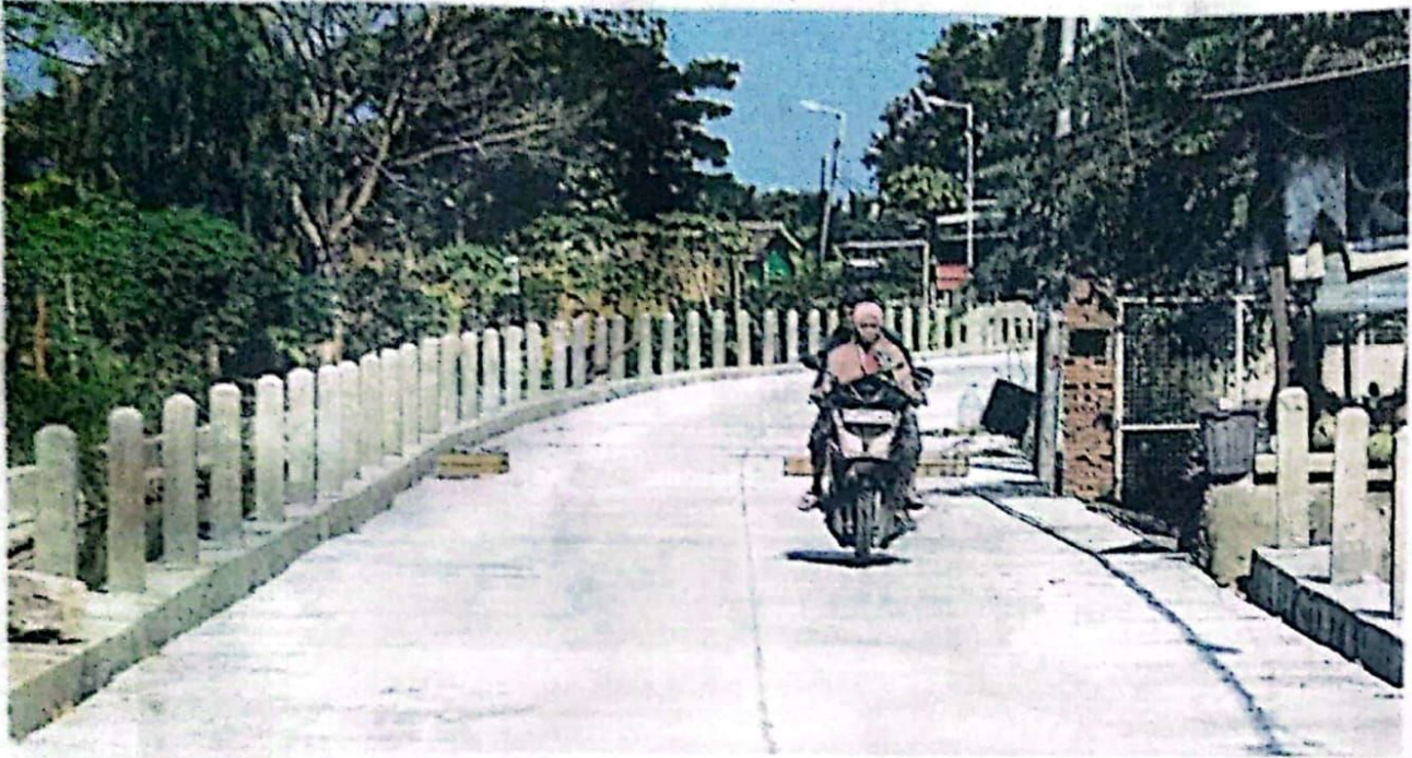
TUNTAS DESEMBER: Pengendara melintas di ruas Jalan Banjarsari-Damarsi yang sedang dibeton kemarin (11/10). Proses betonisasi ruas jalan tersebut mencapai 70 persen.
