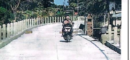
Fondasi Lantai Kerja Sempat Retak, Kini Diperbaiki
