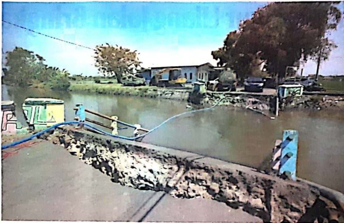
DARURAT: Perumda Delta Tirta mendistribusikan air bersih menggunakan slang karena mobil tangki tak bisa melintas akibat Jembatan Kedungpeluk ambrol.
