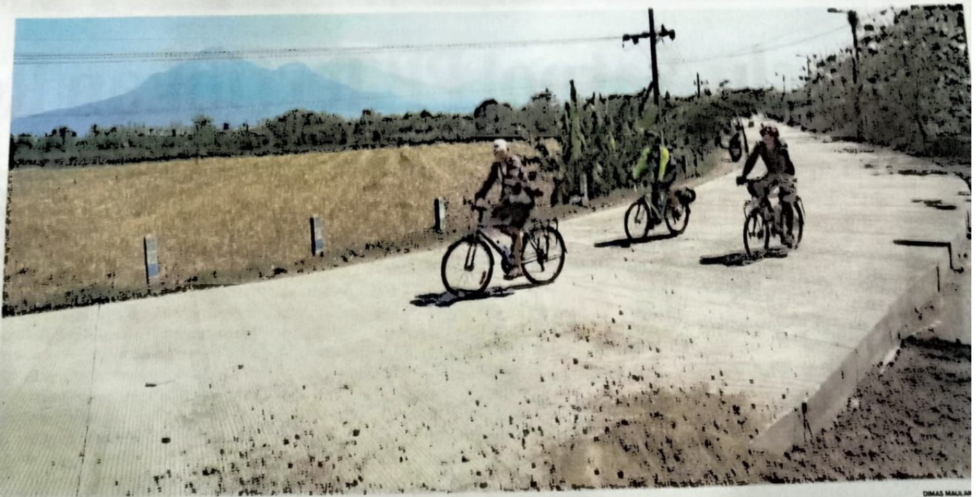
PEMUCU KERETAKAN DITEMUKAN: Pesepeda melintas di sekitar proyek betonisasi Jalan Krebung kemarin (28/9). Salah satu penyebab keretakan adalah kurangnya frekuensi penyiraman air setelah beton dihamparkan. Setelah penyebab keretakan diketahui, betonisasi Krebung-Mojaruntut dilanjutkan.
