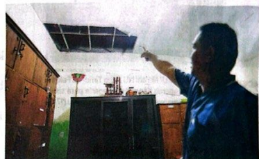
RUSAK: Ari, penjaga SMPN 3 Porong, menunjukkan plafon ruang guru yang jebol kemarin (18/5).
