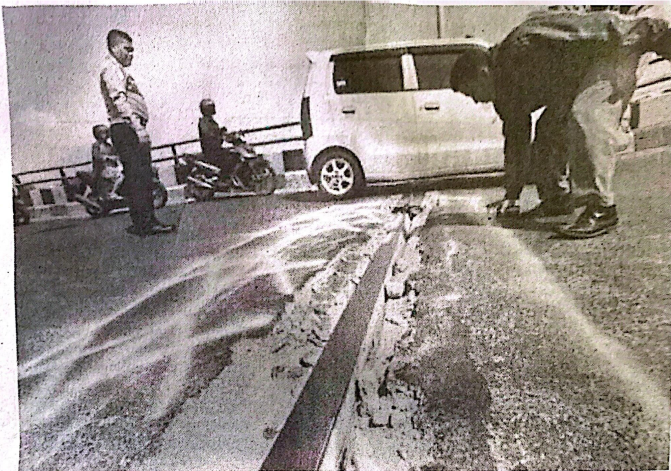
Girder Jembatan Porong Sidoarjo yang renggang ditandai petugas dengan cat.
