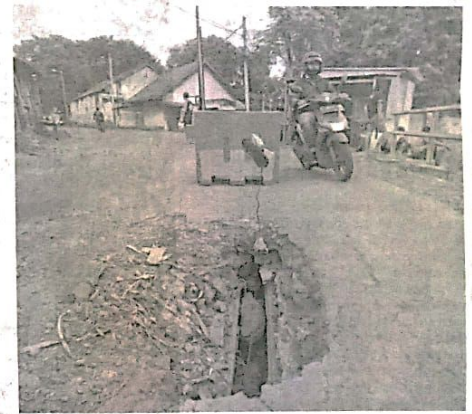
BOLONG : Kondisi Jembatan Krembung membutuhkan penanganan.
