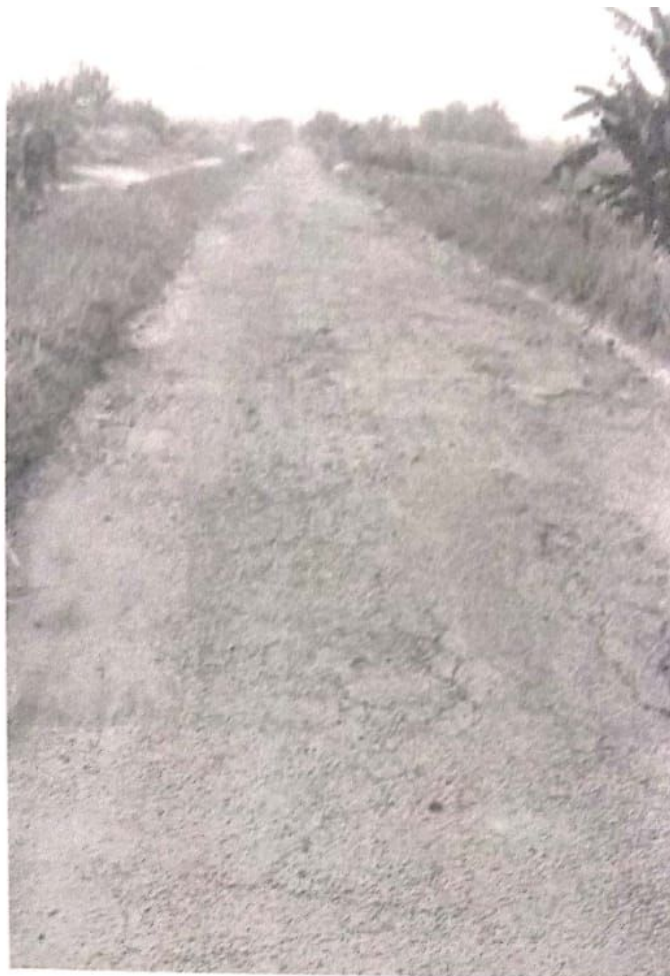
JALAN RUSAK: Kondisi jalan rusak di perbatasan Desa Mojoruntut dan Desa Tanjekwagir.(gus)
