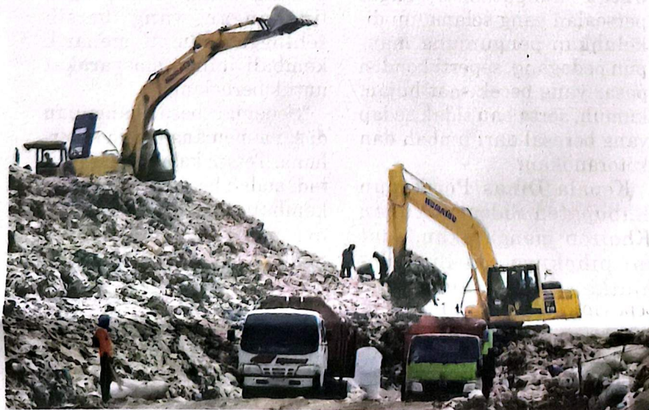
ANTISIPASI: Kondisi TPA Jabon masih overload.
