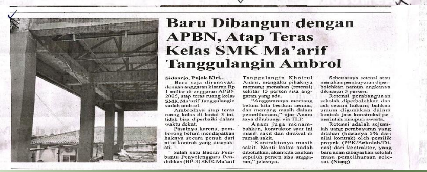
Baru Dibangun dengan APBN, Atap Teras Kelas SMK Ma'arif Tanggulangin Ambrol
