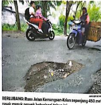
BERKUNYANG: Ruas Jalan Kemangren-Krian sepanjang 450 meter yang rusak masuk proyek betonisasi tahun ini.
