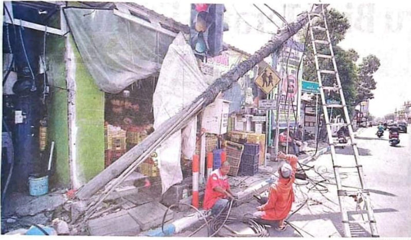
RUSAK: Petugas PLN dan Telkom merapikan kabel di Jalan Diponegoro. Kabel menjuntai karena tiang listrik miring.
