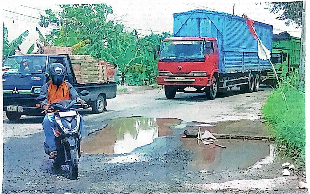
PARAH - Kondisi Jalan Raya Simpang Prambon, Sidoarjo rusak parah. Selain mengganggu lalu lintas, juga berbahaya bagi pengendara. Terutama saat malam hari.
