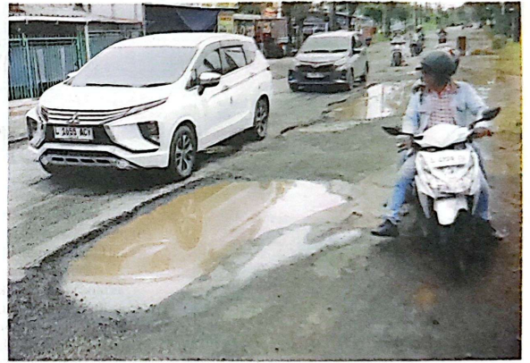
RUSAK PARAH: Perbaikan Jalan Lingkar Timur yang dipenuhi lubang itu ditargetkan tuntas sebelum Lebaran.
