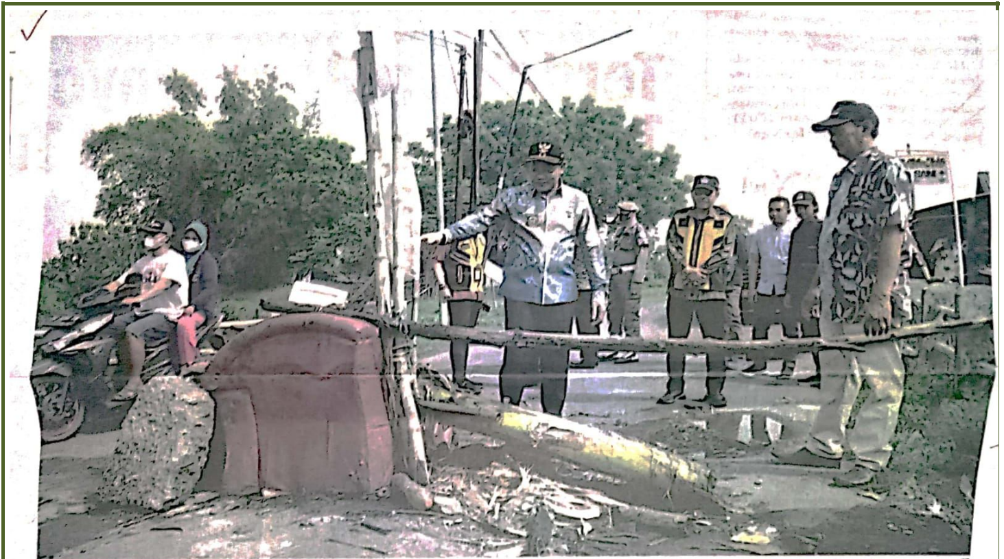
DIPASANG SOFA: Wakil Bupati Sidoarjo Subandi (berdiri dua dari kiri) saat meninjau kondisi jembatan Desa Prasung yang rusak.
