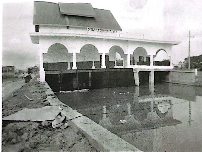
SEMPAT MOLOR: Rumah Pompa di Kedungpeluk Candi sudah rampung dikerjakan.
