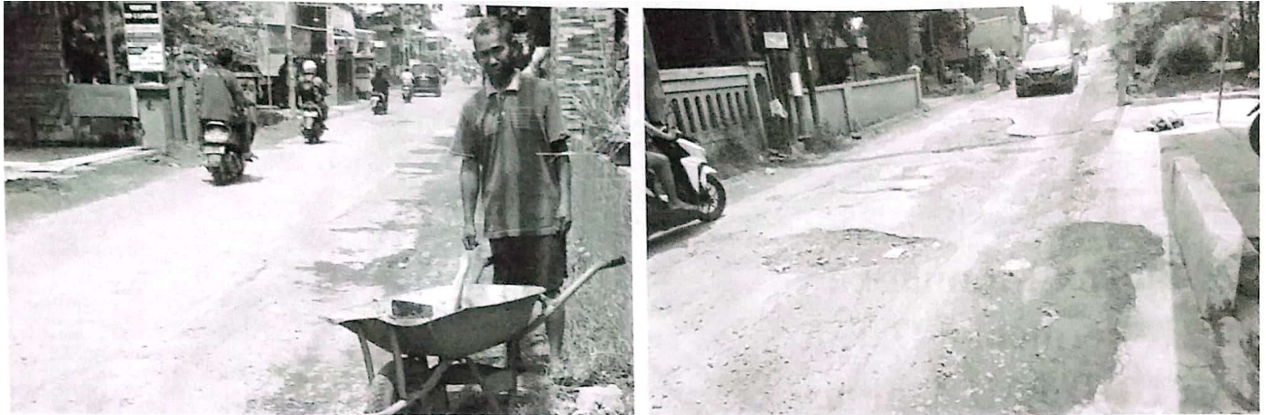
Jalan rusak akibat galian pipa pdam di Jumputrejo
