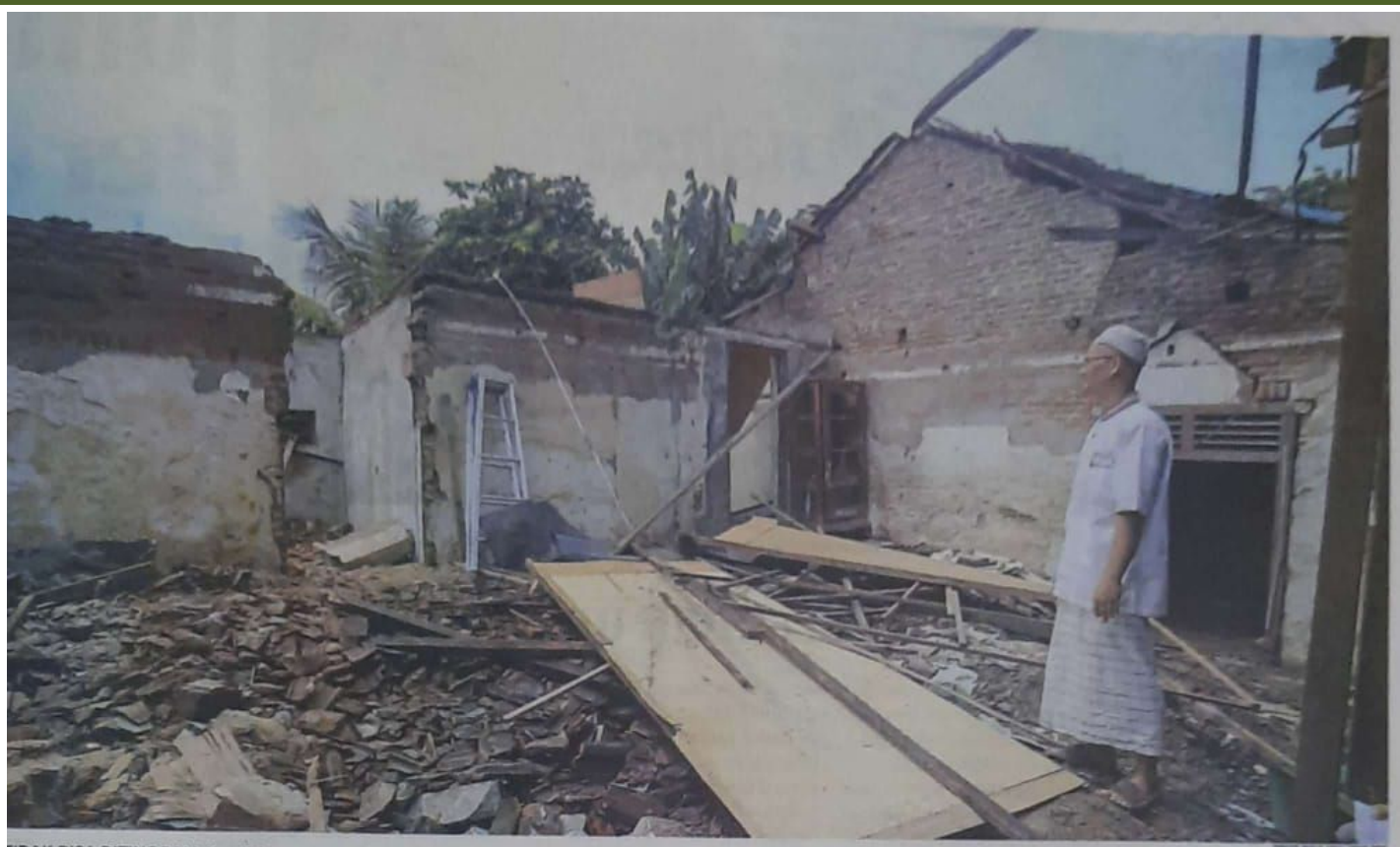
TIDAK BISA DITINGGALI: Kondisi rumah Rusli Kholil yang ambrol akibat intensitas hujan tinggi di Tambak Sawah, Waru, kemarin.
