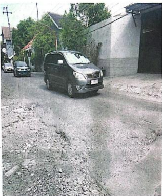
RUSAK: Salah satu Jalan Pepelegi Kecamatan Waru yang akan diperbaiki.
