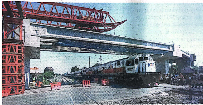
TERPASANG MELINTASI REL KERETA: Kondisi terakhir proyek pembangunan flyover Krian, Sidoarjo, kemarin (18/6).
