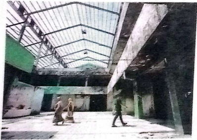
MAANGKRAK: Ratusan kios di Pasar Krian rusak setelah kebakaran pada 2024.
