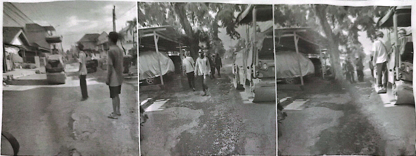
Proyek tambal sulam PIWK jalan Pahlawan 7 Kwadengan yang diduga dikerjakan acak-acakan asal jadi.
