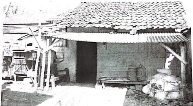
Kondisi salah satu rumah sasaran renovasi di Kecamatan Porong.
