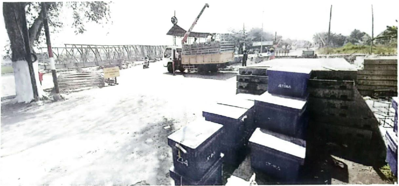
JEMBATAN SEMENTARA : Rangkaian konstruksi jembatan bailey sudah mulai dirangkai oleh pekerja di lapangan.
