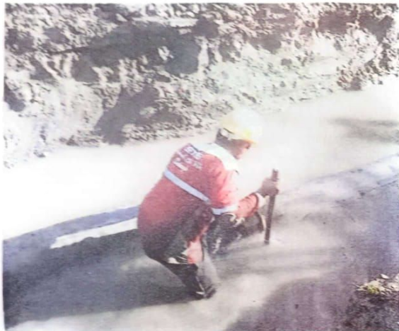
KERJA CEPAT: Petugas memperbaiki pipa air yang bocor di Desa Banjarsari, Buduran, kemarin (20/6).
