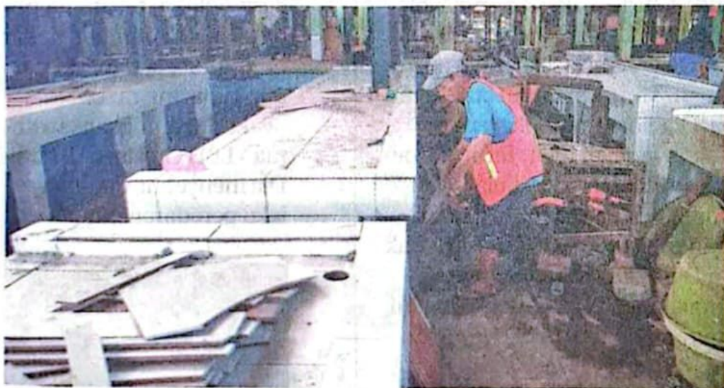
TAK SESUAI SPESIFIKASI: Kontraktor revitalisasi Pasar Taman ditegur pemkab setelah ditemukan sejumlah permasalahan dalam proyek.
