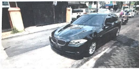
PROSES Pengerjaan: Kendaraan melintas di Jalan Sekardangan kemarin. Jalan tersebut tengah diperbaiki, tetapi hanya saat malam hari.
