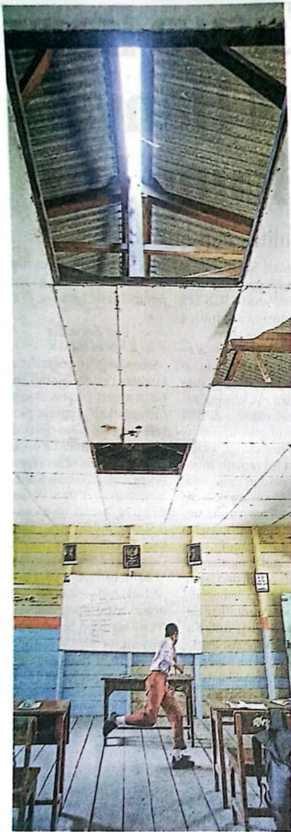
BOLONG: Ruang kelas SDN Kupang 4 sering banjir saat hujan karena plafon rusak. Foto kanan, Wakil Bupati Sidoarjo Mimik Idayana mengecek tembok sekolah yang mengelupas.
