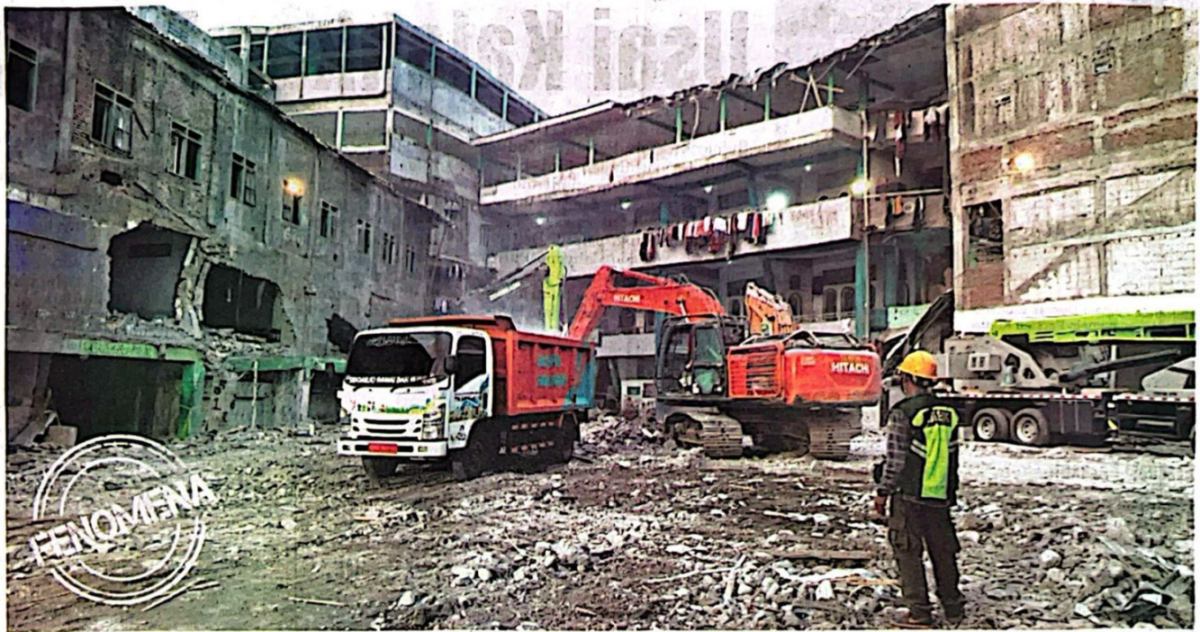
RAMPUNG: Proses evakuasi korban ambruknya Musala Ponpes Al-Khoziny resmi berakhir. Alat berat sudah ditarik dari lokasi kejadian.
