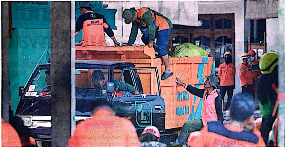
MENUJU TPA: Truk DLHK Sidoarjo membawa puing material bangunan musala yang ambruk di Pondok Pesantren (Ponpes) Al- Khoziny, Kecamatan Buduran, kemarin (7/10).
