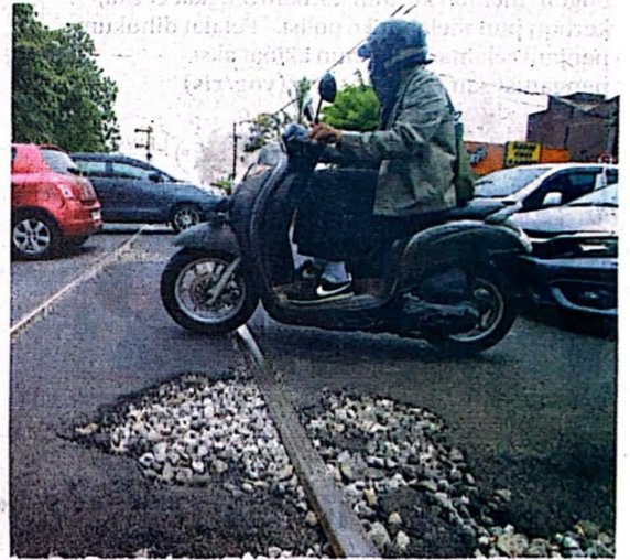
BARU DIPERBAIKI: Aspal mengelupas di perlintasan KA Jalan Pahlawan.
