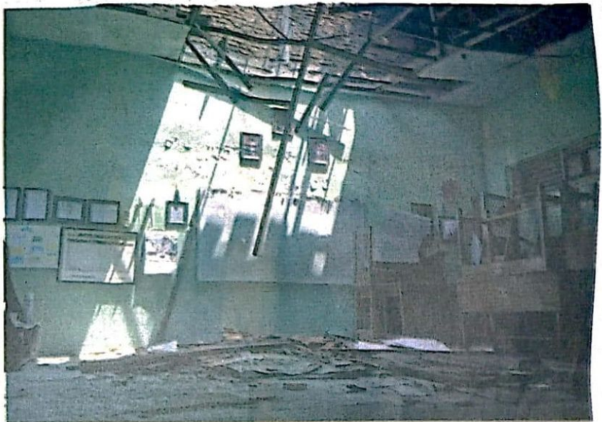
PERBAIKAN: Kondisi atap kelas SDN Waru 2 rusak pada akhir Maret lalu.
