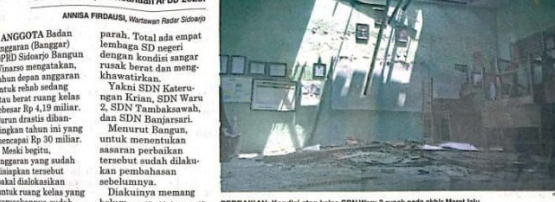
PERBAIKAN: Kondisi atap kelas SDN Wiru 2 rusak pada akhir Maret lalu.
