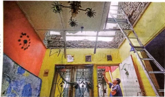
BOLONG: Luh Erni, warga Desa Sidokepung, Buduran, menunjukkan plafon rumahnya yang rusak parah.
