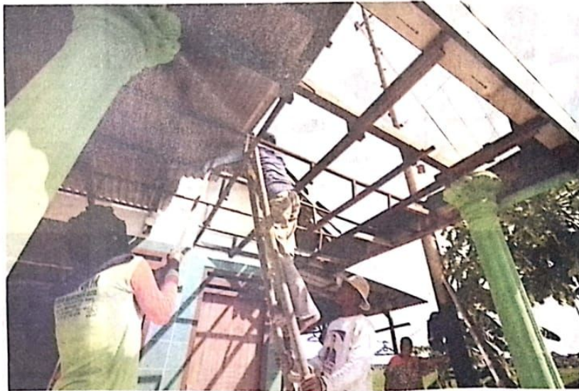
PERBAIKAN: Warga gotong royong memperbaiki satu di antara delapan rumah yang tersapu puting beliung di Desa Pertapan Maduretno, Taman, kemarin (4/6).
