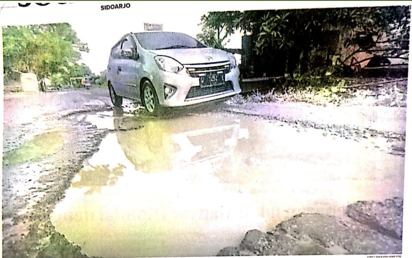
TIDAK SEGERA DITAMBAL: Pengendara menghindari lubang di Jalan Doro, Desa Banjarsari, Kacamatan Buduran, kemarin. Jalan tersebut rusak akibat pengerjaan proyek pipa air minum.
