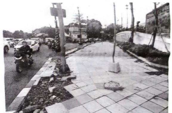
COPOT: Kondisi trotoar GOR Delta yang sudah rusak.
